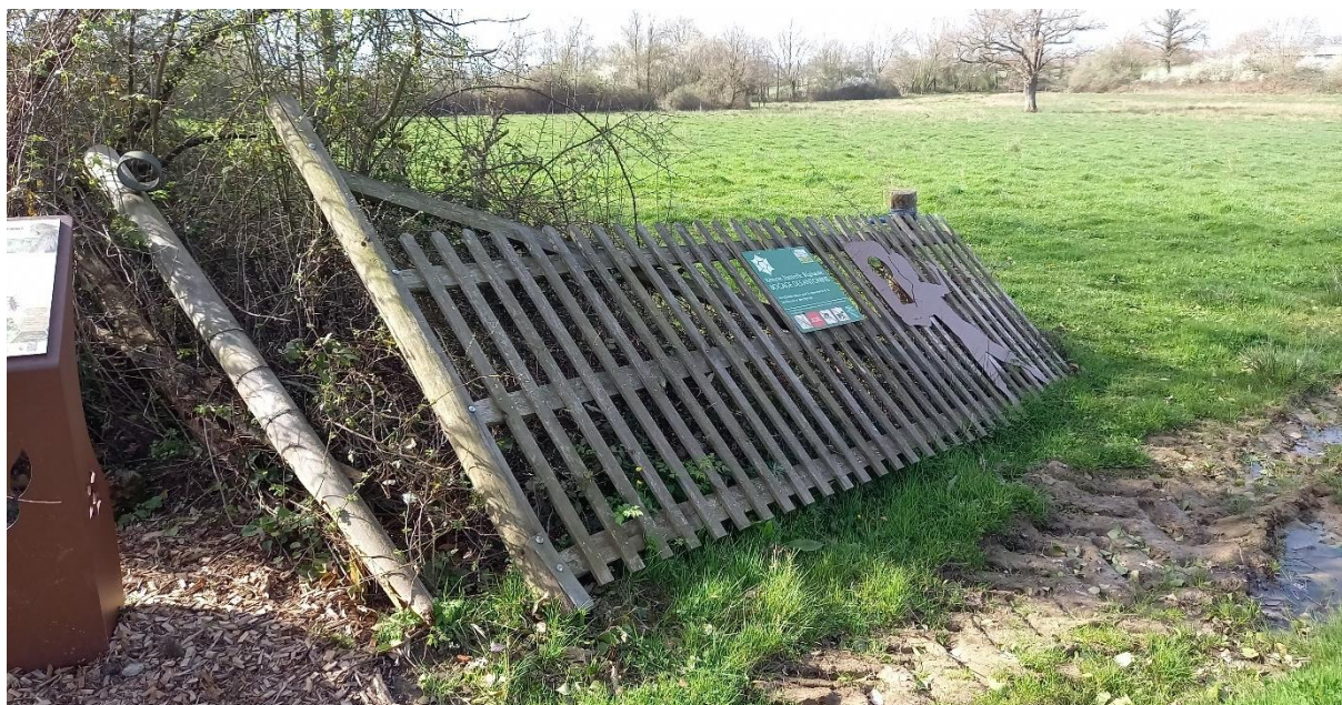
Figure 105 : Barrière de Gâtine cassée avant restauration. © Alexandre Boissinot
